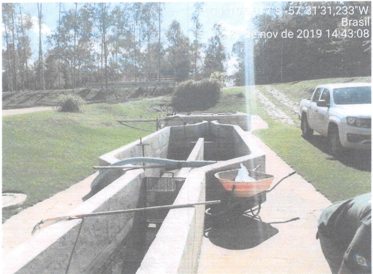
Foto 02: Vista do sistema preliminar de tratamento de esgoto
