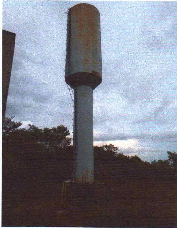
Reservatório R2 tipo taça, 30 m 3
