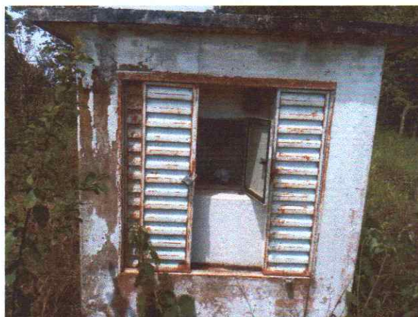
Quadro de comando P4 – condições precária
