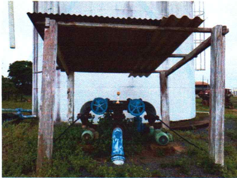
Pressurizadora de água tratada
