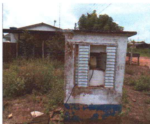
cabine de quadro de comando
