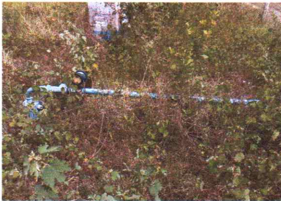
P4 instalação irregular
