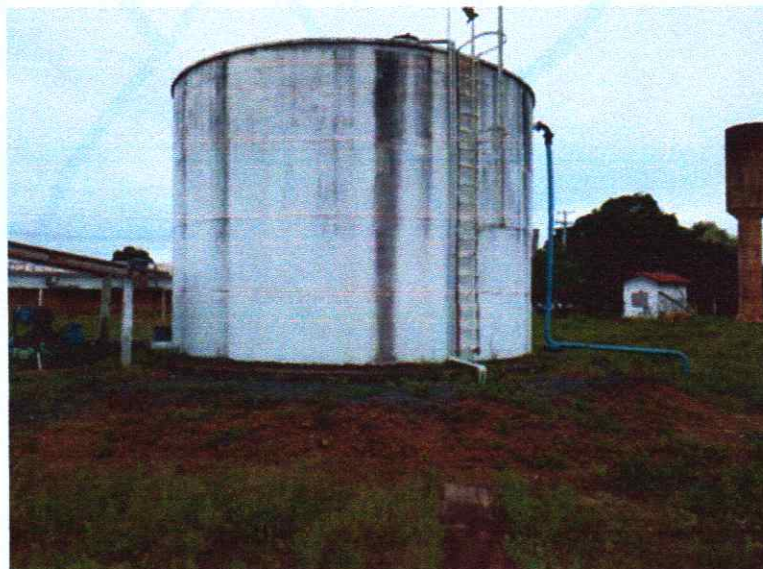
Reservatório metálico 150m 3
