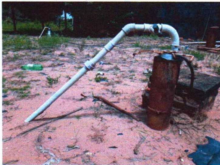
Captação Poço 1 - Águas Claras
