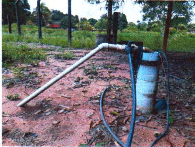
Captação Poço 2 - Águas Claras
