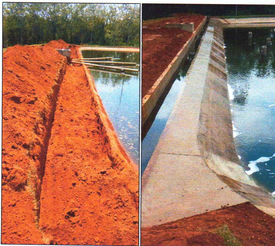
Imagem 44 - Mudança na lagoa de esgoto com implantação da calha, melhorando a distribuição e oxigenação. Ano: 2018.
