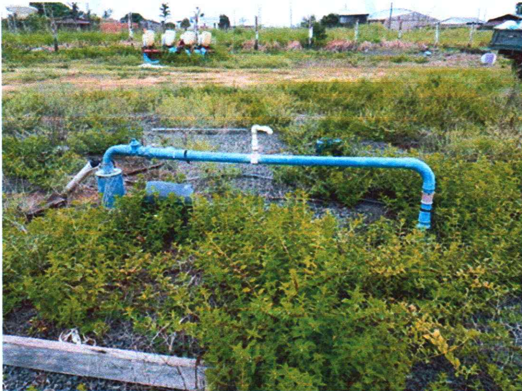
Captação Poço 1 – Distrito de Paranorte
