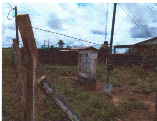
P5, área de locação e instalações precária
