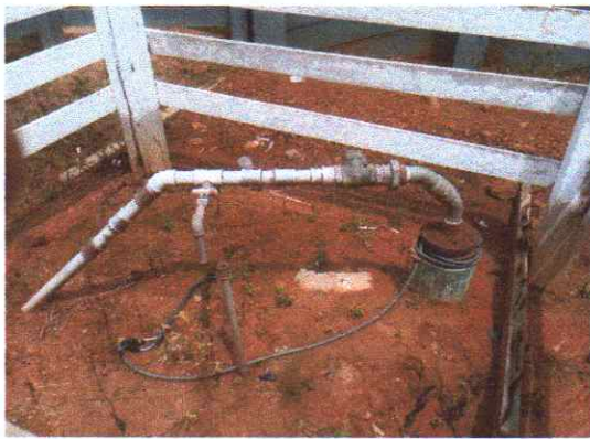
P3 instalações precária e inadequadas
