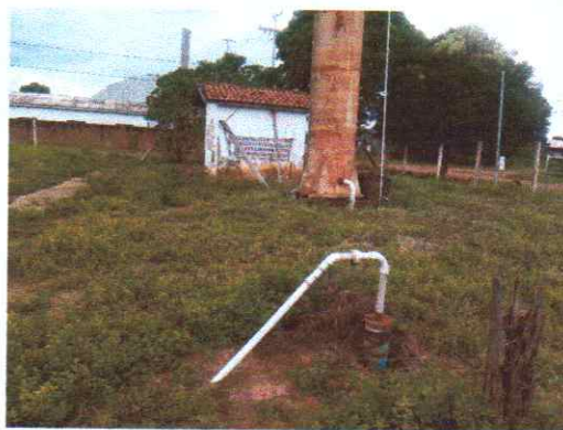
P2 instalações precárias e inadequadas
